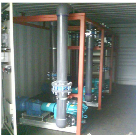
Instalación de bomba de permeado reversible en Lalbuksh Voltas LLC, Oman
